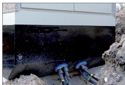
Obr. 2. Prostupy kabelů do podzemní vany kompaktní stanice
