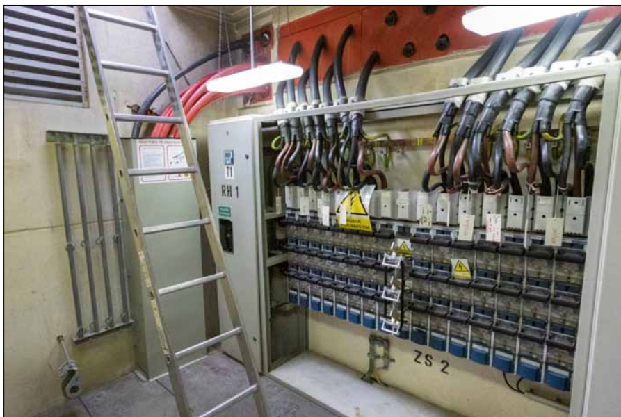
Obr. 1. Interiér podzemní trafostanice
